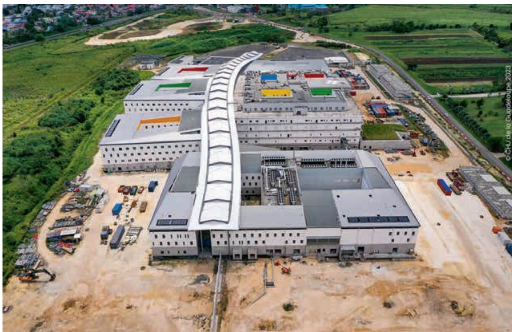
Chantier du nouveau CHU de la Guadeloupe situé à Belle-Plaine Abymes © CHU de la Guadeloupe
